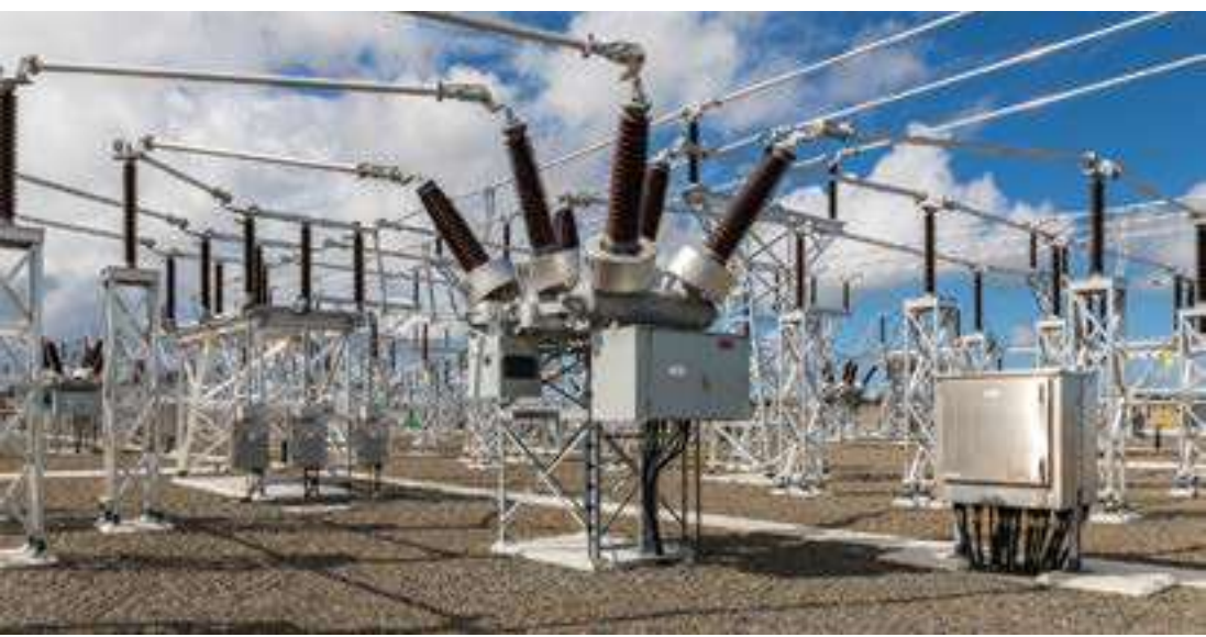
A primeira subestação da empresa no município foi construída em uma área de 10 mil metros quadrados e irá atender mais de 6 mil pessoas
