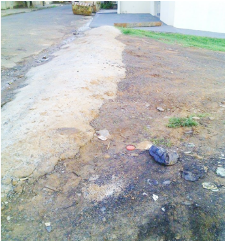
Uma espécie de 'lombada' irregular foi construída por um morador e atormenta vizinhos em dias de chuva forte
